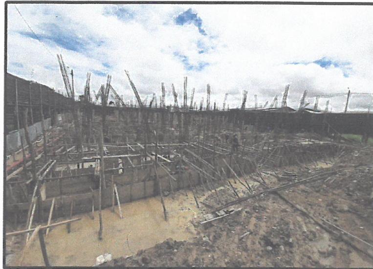
VISTA GENERAL DE ENCOFRADO DE CIMENTACIONES Y VIGAS DE CIMENTACIÓN EN C.S. ISLANDIA
