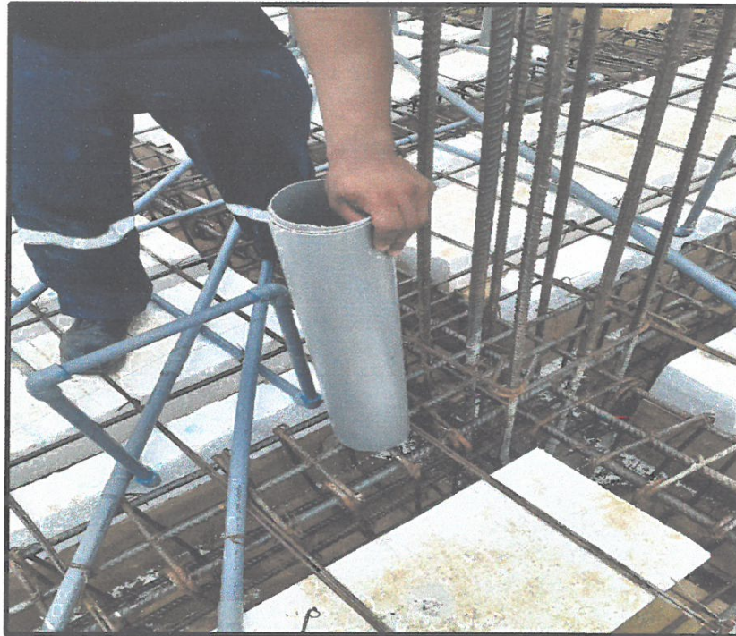
INSTALACIONES SANITARIAS EN CONTINGENCIA - ISLANDIA.
