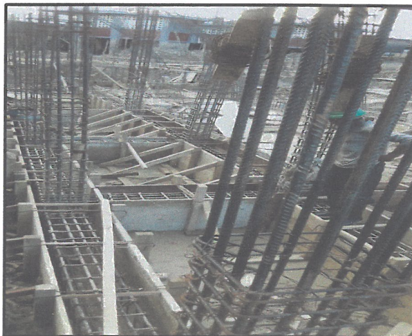
ENCOFRADO Y ARMADURAS DE ACERO EN VIGAS DE CIMENTACIÓN EN C.S ISLANDIA.
